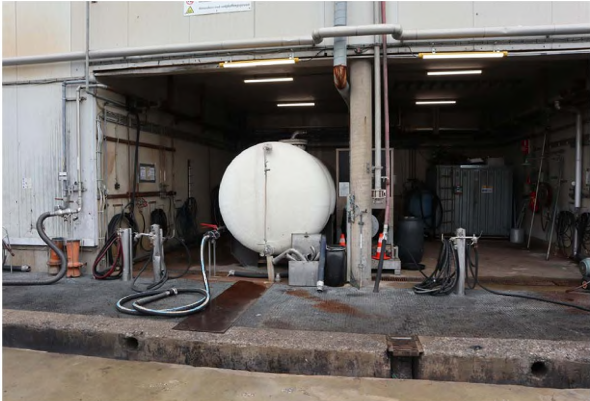
▲ Figuur 2: Foto van de installatie voor special cleaning met op de voorgrond de utility-plaat en de washal met de witte uitstoomtank zichtbaar in de hal (bron: Onderzoeksraad voor Veiligheid).
