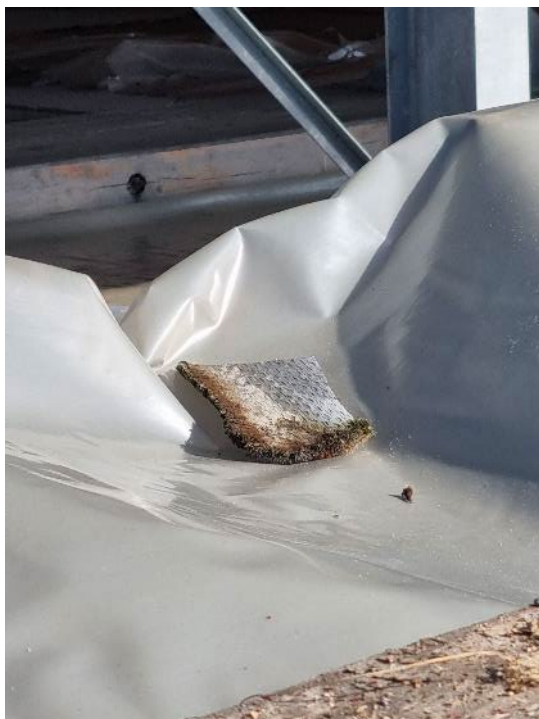
Foto 11: Stukje afgebroken golfplaat
